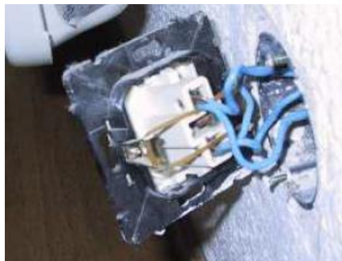
Enchufe sin toma de tierra
