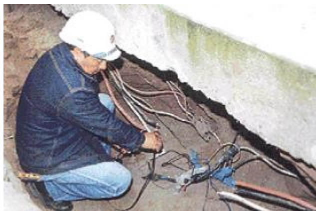
Trabajador mal protegido
